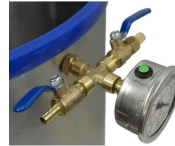
Photo n° 6: Îlot de vannes correctement installé.
