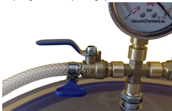
Zdjęcie nr 8: Wąż pneumatyczny zamocowany na króćcu zaworu kulowego, zabezpieczony opaską ślimakową.
